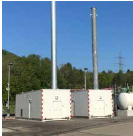
Reserveheizcontainer mit Öltanks
